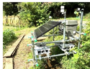
(株)ウェザーニューズ様の支援の一環として、気温、湿度、気圧、雨量、風速、風向、照度を連続測定するソラテナ Pro を設置
